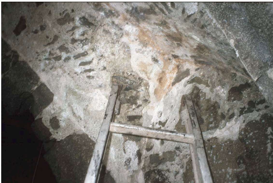
Fig. 36. Domkyrkoruinen i Kirkjubøur Färöarna. Bruksprov Dom Fö 9. Putsbruk med kalkfärg. Sydmuren, invändigt ovansidan västportalen. Foto: Sölve Johansson 2007.
