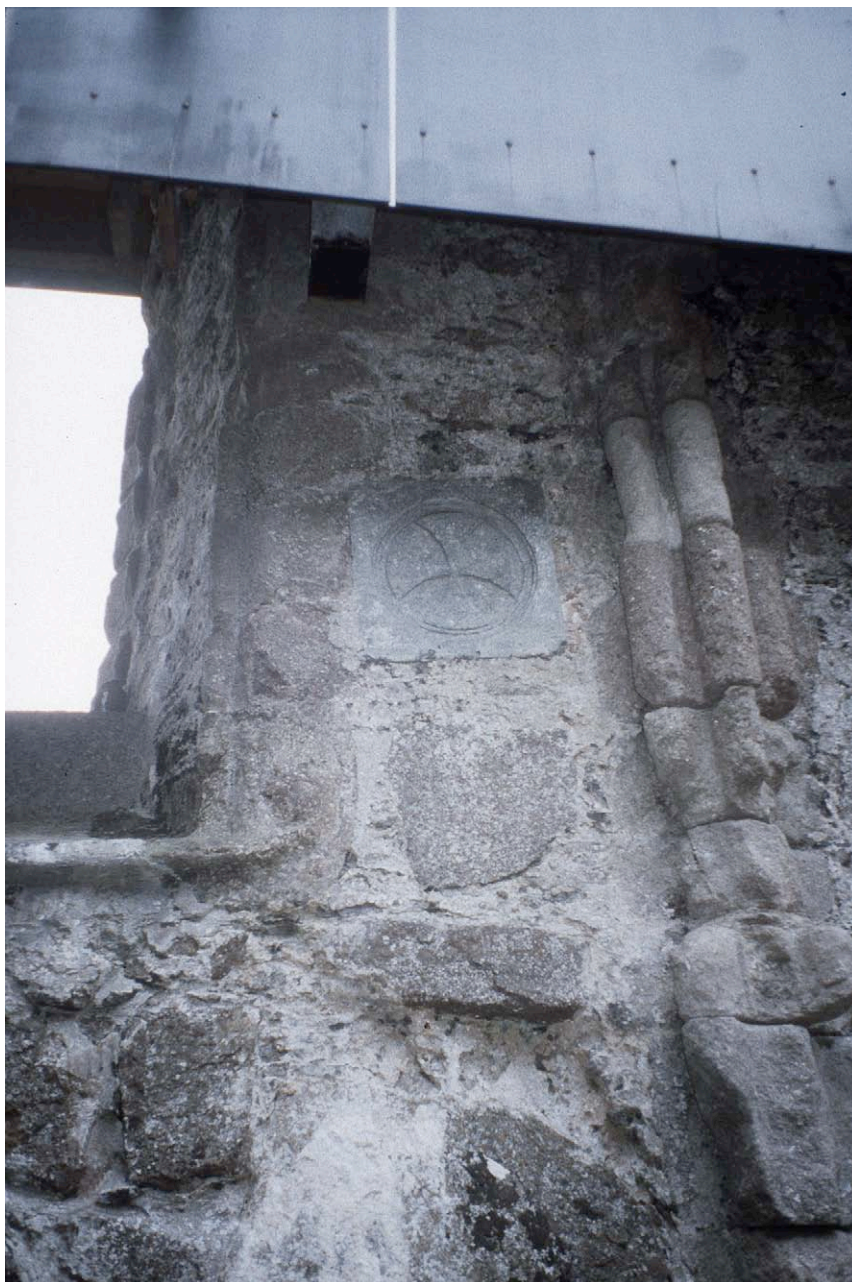
Fig. 24. Domkyrkoruinen i Kirkjubøur Färöarna. Bruksprov Dom Fö 5. Putsbruk (utstruken fog). Sydmuren, invändigt, strax väster om invigningskorset åt öster, ca 3 meter från marken. Foto: Sölve Johansson 2007.
