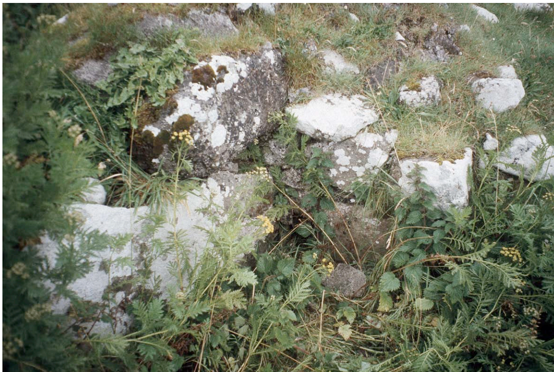
Fig. 49. Likhuset i Kirkjubøur Färöarna. Bruksprov Lik Fö 2 Mur/putsbruk. Norra muren, skiljemur, åt sydväst. Foto: Sölve Johansson 2007.
