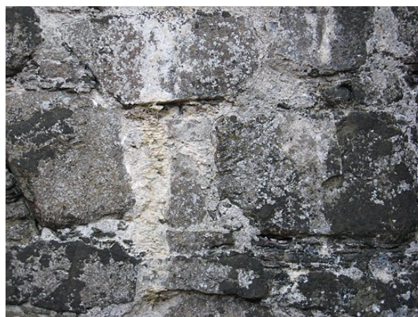
Figur 2.2. Udfældning af kalk på Murens overflade som følge af udvaskning af mørtlen af gennemsivende regnvand.
