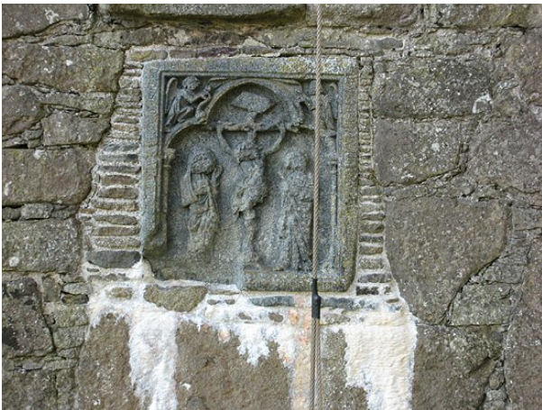
Figur 1.7. Relikvieskabet på østgavlen. Dækstenen er udført af vejrbestandig klæbersten. Kalktapet skyldes udvaskning af mørtel fra ommuringen i 1979.
