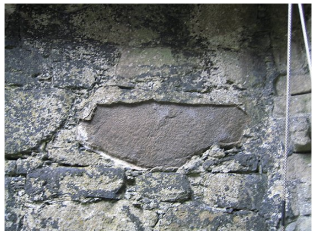
Figur 1.2. Eksempel på afskalning (exfoliation) af overfladen på en basaltblok på indersiden af den nordlige mur.
