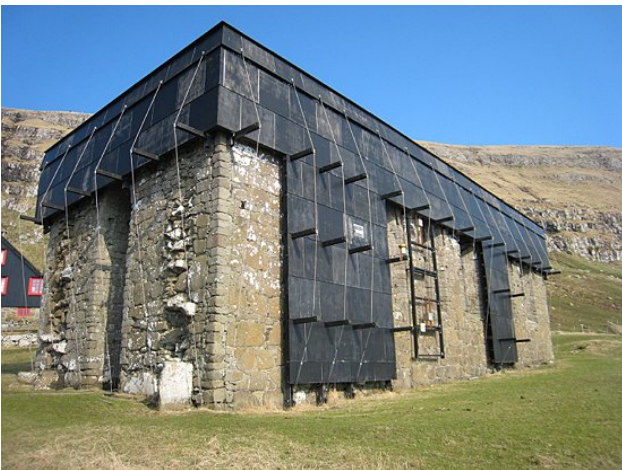
Figur 3.3. Murens vest- og sydside med måleudstyret opsat. Feltet uden beklædning midtpå muren blev anvendt til afprøvning af en perforeret afdækning (strækmetal).
