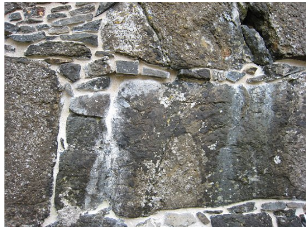
Figur 2.6. Prøverestaurering af fuger på nordsiden af nordmuren. Den viste prøve bestående af kalkmørtel med Metastar er ikke vejrbestandig.
